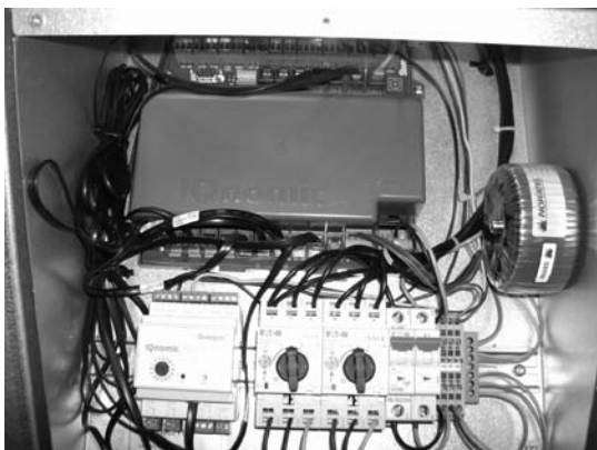
11. Återmontera grå plastkåpa med texten IQnomic./ Reassemble the grey plastic hood with the text IQnomic.
