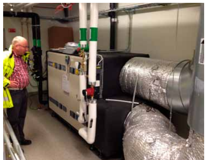
Il tecnico Björn Adler che controlla un'unità di trattamento aria GOLD. Foto: Swegon
