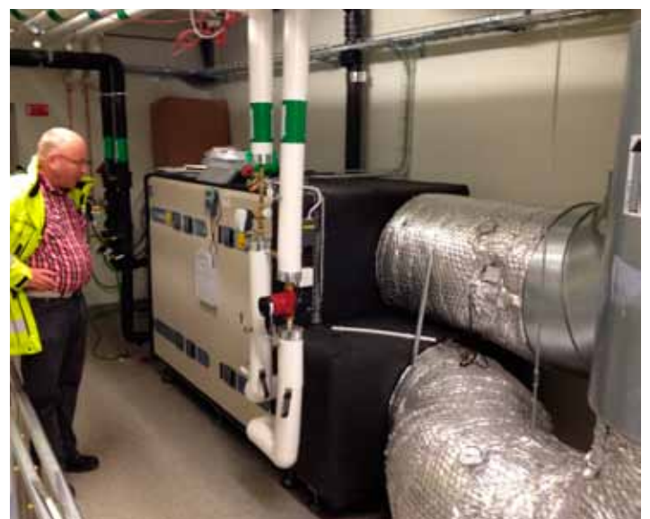
Björn Adler (technicien) inspectant une centrale de traitement d'air GOLD. Photo: Swegon
