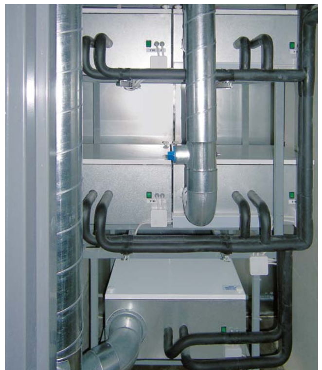
Viiden asunnon tuloilmakoneet sijoitettuna kerroskohtaiseen konehuoneeseen.
